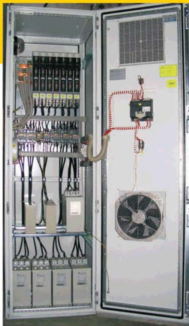
Fig. 1 Vedere interioară a unui dulap de compensare a puterii reactive.
